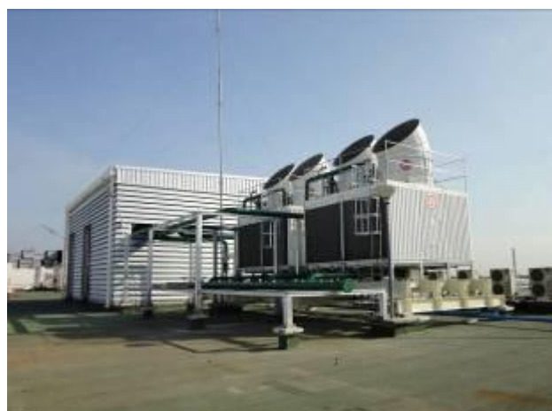
空調用冷凍機室と冷水塔
